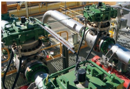
10-дюймовые клапаны MOGAS 600 класса с гидротрибными приводами установлены в цехе кислотного выщелачивания никеля под высоким давлением.
