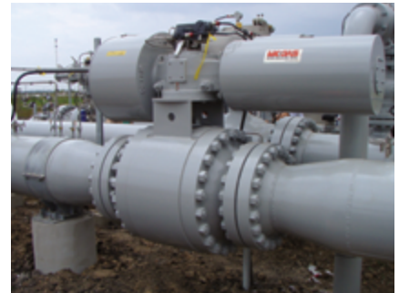
Estas válvulas MOGAS de gran diámetro interno han tenido un funcionamiento exitoso durante años en esta gran cueva de almacenamiento subterráneo.
