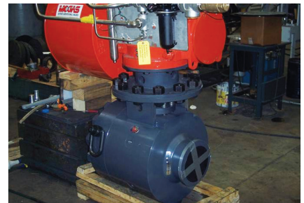
Vanne d'isolement de la pompe sur le circuit de recirculation de la chaudière. Vanne fournie avec des embouts Clamp haute pression afin de faciliter la dépose en cas de réparation. Ceci afin d'éviter la découpe d'épaisseurs soudées et le traitement thermique post-soudage.
