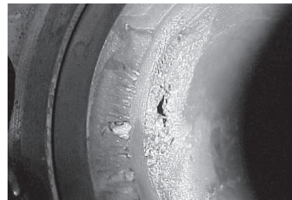
Comme le montre cette vanne d'un concurrent, si les sièges ne sont pas protégés d'une exposition continue à la vapeur haute pression, ils peuvent faire l'objet d'une érosion destructive.
