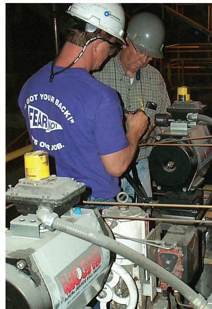
Estas quatro válvulas esféricas GEN-X, de 2 polegadas, da MOGAS, operam com isolamento do reaquecedor frio em uma usina alimentada a carvão.
