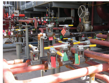
Esta usina de gás natural de ciclo combinado recentemente construída irá se beneficiar da eficiência das válvulas iRSVP da MOGAS em seus drenos e exaustores HRSG.
