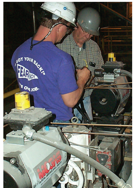
这四个 2 英寸 Gen-X MOGAS 球阀正在控制某家燃煤电厂的冷再热隔离。
