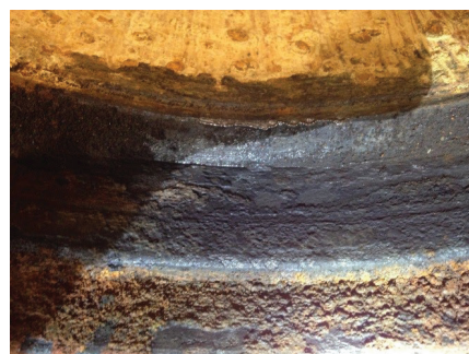
La pérdida de material en la cavidad del asiento fue causada por la corrosión galvánica, lo que permitió que se produjeran fugas alrededor de los asientos de las válvulas.
