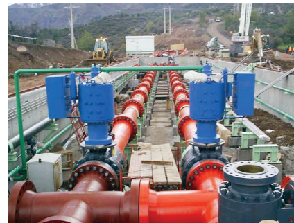
Estas válvulas de bola Clase ASME 900 de 60,96 cm (24 pulgadas) en una estación disipadora tienen un tiempo de carrera de 45 segundos para manejar concentrado de cobre con una velocidad de flujo de 1 167 litros por segundo.
