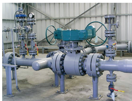
Esta estación de bombeo de hidrot transporte tiene válvulas de bola con asiento metálico Clase ASME 1500 de MOGAS de 15,24 y 20,32 cm (6 y 8 pulgadas), así como numerosas válvulas de drenaje Clase ASME 1500 de 5,08 cm (2 pulgadas), que han estado funcionando desde 1994.
