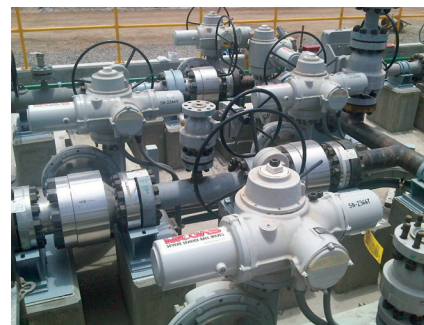
La confiabilidad absoluta de estas válvulas de aislamiento CST-1, de 15,24 cm (6 pulgadas) es muy importante debido a los efectos adversos que genera el mineral enlodado, además de estar ubicado a 1 430 metros sobre el nivel del mar.
