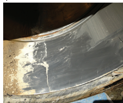
En las mismas condiciones de proceso, la válvula de la competencia tuvo un rendimiento inferior y requirió un mantenimiento frecuente debido a la erosión.
